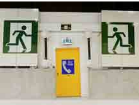
Fluchtwegkennzeichnung | Airport Link | Brisbane | Australien
