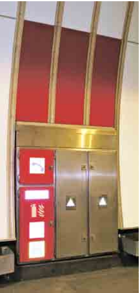
Sicherheitsbox | Cuilfail Tunnel | Großbritannien
